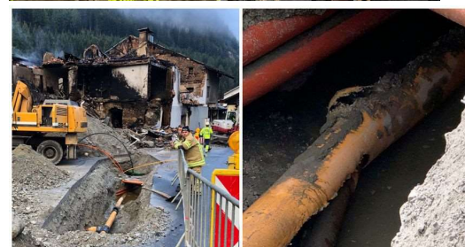
Brandbekämpfung durch die Feuerwehren des Wipptals (o.) Brandruine (u. r.) Angebohrtes Rohr (u. l.) Quelle: TT
